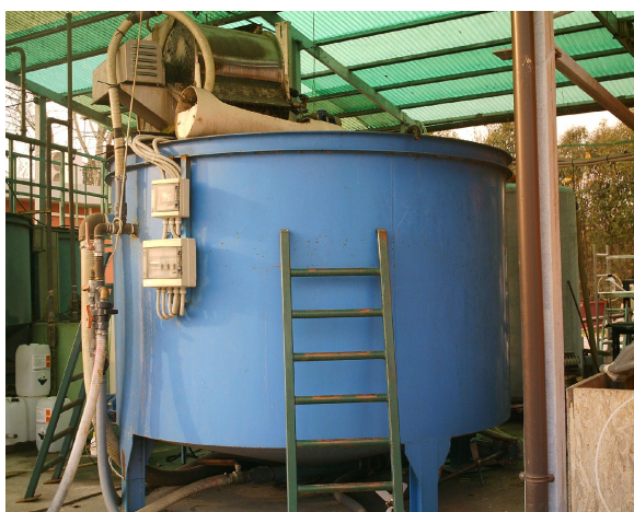
Figura 8 – Tanque de equalização
