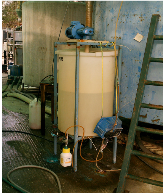
Figura 10 - Tanque para dosagem de carbono, nitrogênio e fósforo
