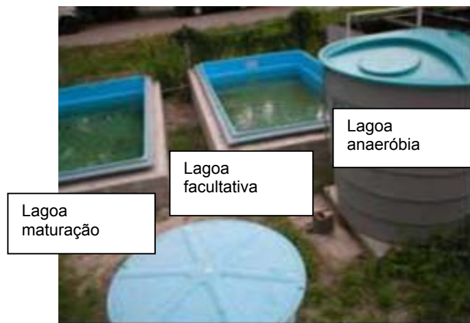
Figura 3 - Sistema de lagoas de estabilização.
