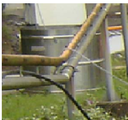
Figura 7 - Foto do tanque de armazenamento.
