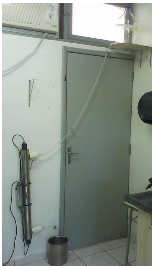
Figura 14 – Instalação do reator UV operado em processo de fluxo contínuo para o tratamento da água de chuva.
