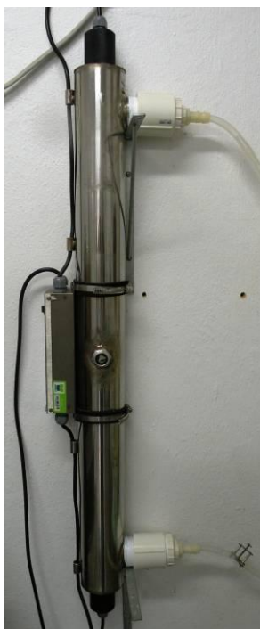
Figura 13 – Fotorreator em aço inox utilizado na desinfecção da água de chuva.
