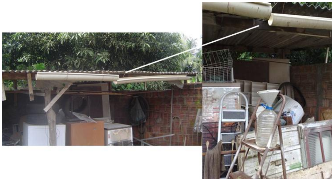
Figura 12 – Coleta de água de telhado na região do Boa Vista.
