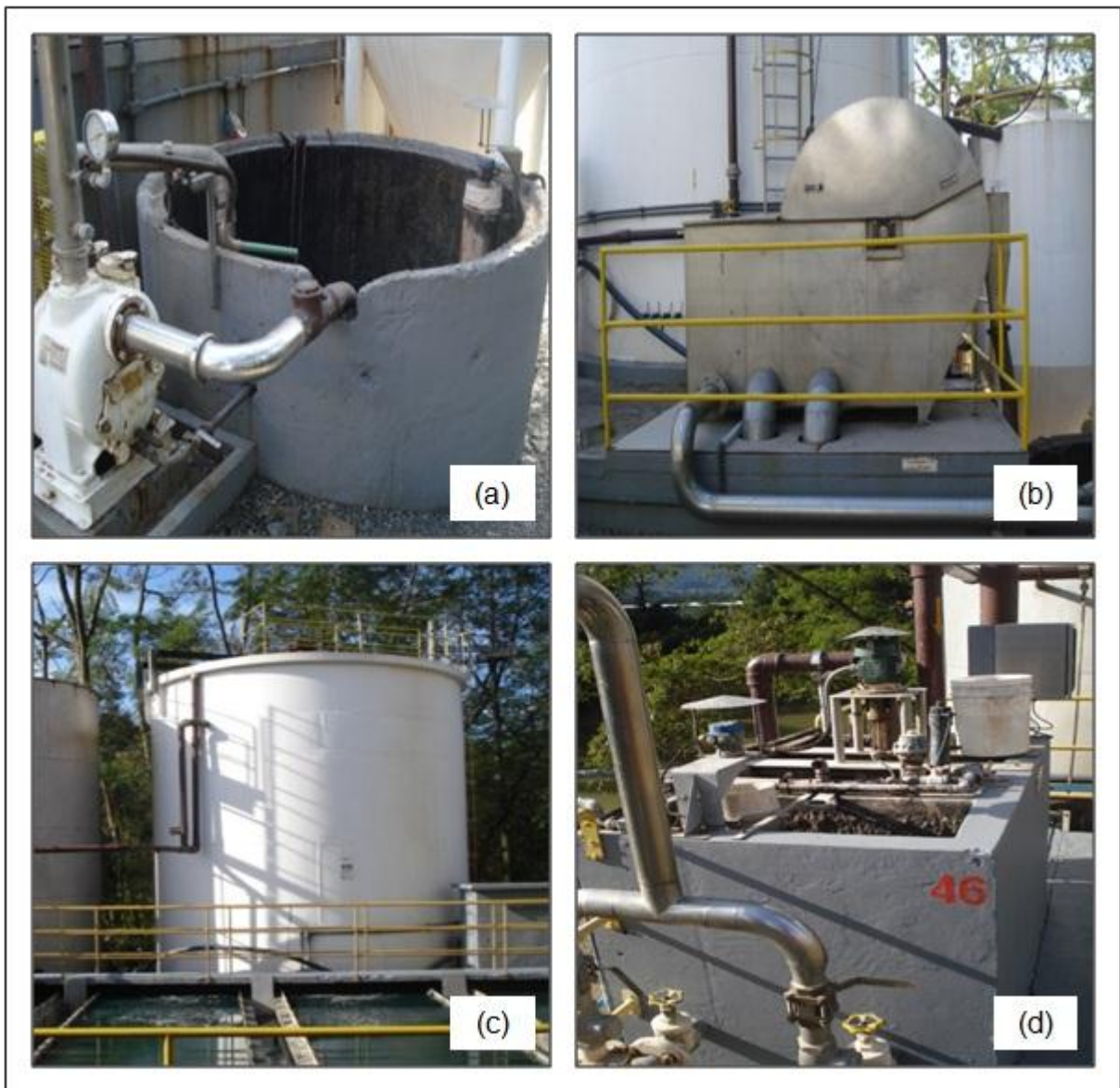
Figura 11 - Estação elevatória de efluente sanitário e industrial (a); peneira rotativa (b); decantador primário (c) e caixa de ajuste de pH (d).
