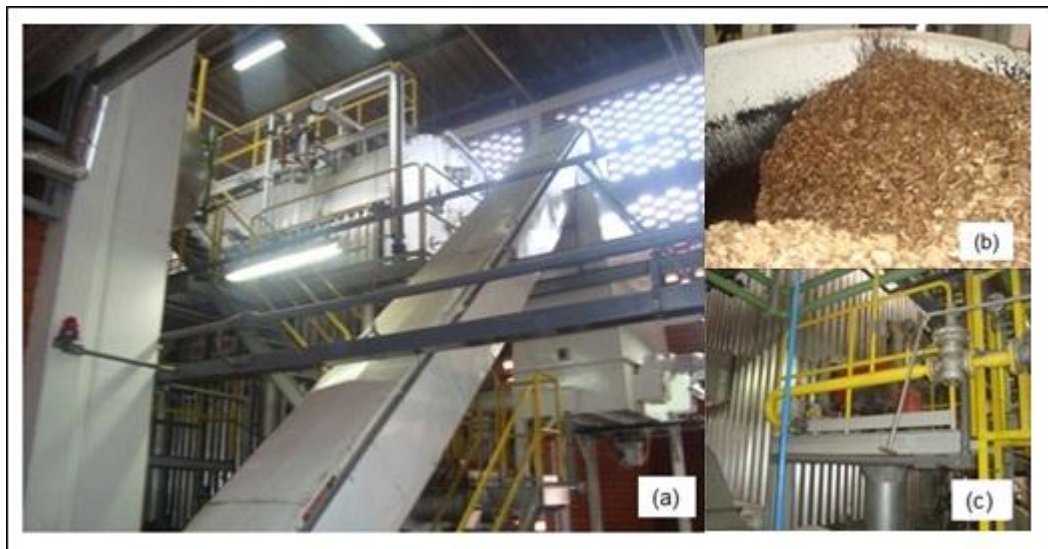
Figura 24 – Caldeira flamotubular da Biochamm utilizada pela Duas Rodas Industrial na geração de vapor: (a) Vista parcial da caldeira; (b) Cavaco de eucalipto utilizado como combustível; (c) Sistema alternativo de combustível para gás natural.
