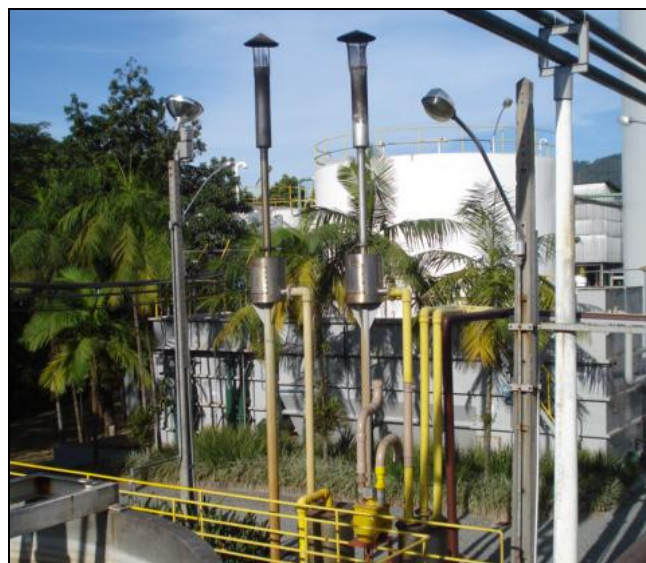
Figura 15 – Queimadores dos reatores 60 e 61.
