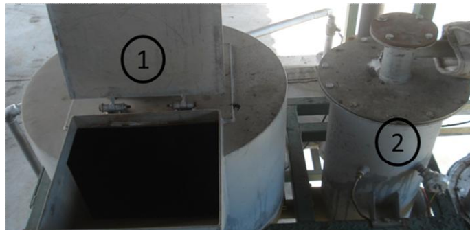
(b) Silo de armazenamento de biomassa (1), reator de pirólise (2)
