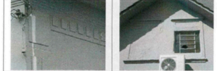
Imagem 18. Detalhe da fachada norte da Edificação 01 - ornatos em relevo de argamassa. Fonte: CPC/FCI. Data: 09.09.2013.
